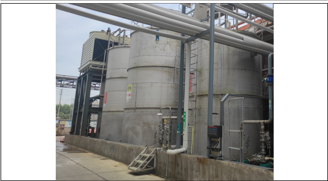
车间废水收集罐
