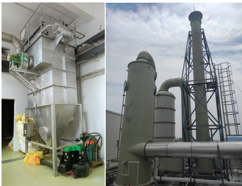
投料及化合废气治理设施及废气排放口（4#）
