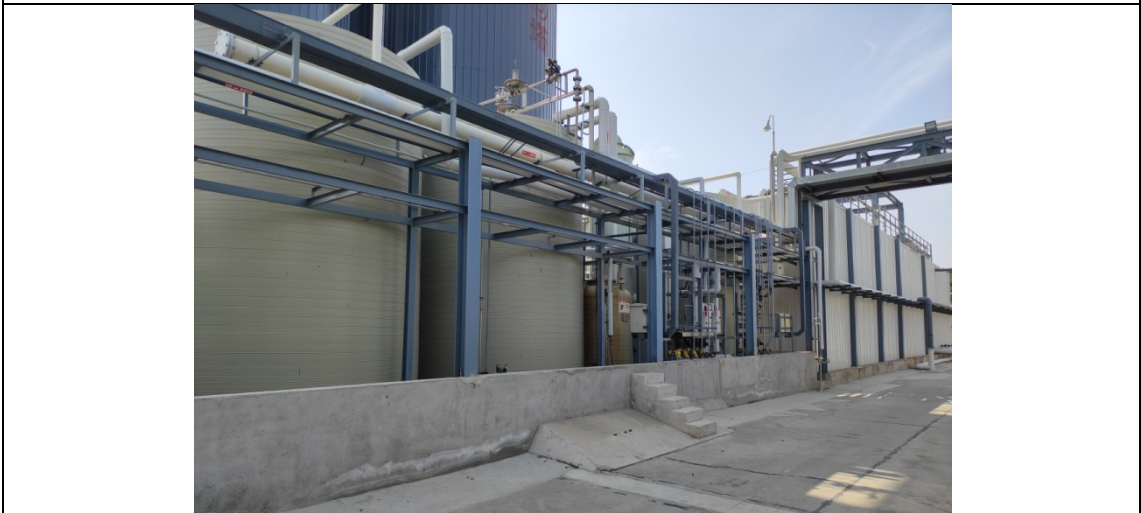
铬黄废水处理站生物脱氮单元
