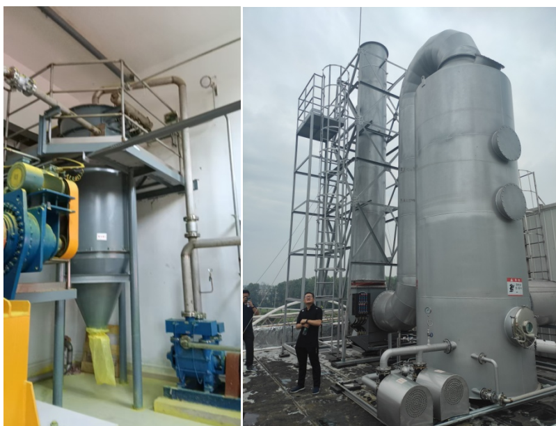
粉尘废气治理设施及废气排放口（26#）
